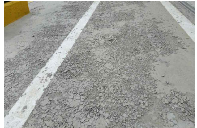
그림 1 공동주택내 지하 및 지상 주차장 콘크리트 열화표면
